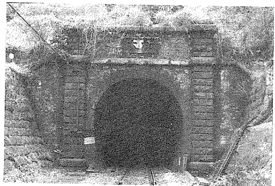
写-5 加太トンネル湊町方坑門[1988] 胸壁には「加太」の題額がかかっている。断面は半径7フィートの単心円タイプを採用した。
