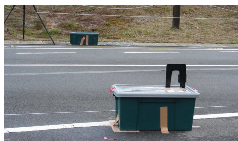
写真-6 車両検知装置
