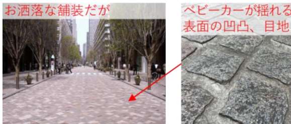
図-5 路面の段差やがたつき
