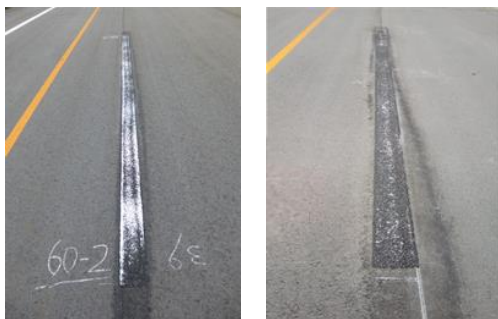
図-5 剥離した区画線
