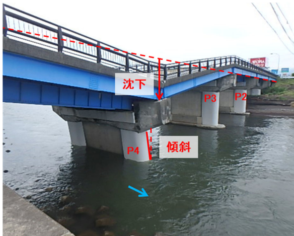
写真-2 P4 橋脚の沈下及び傾斜
