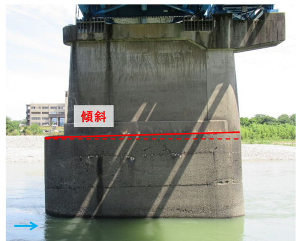
写真-1 P4橋脚の傾斜
