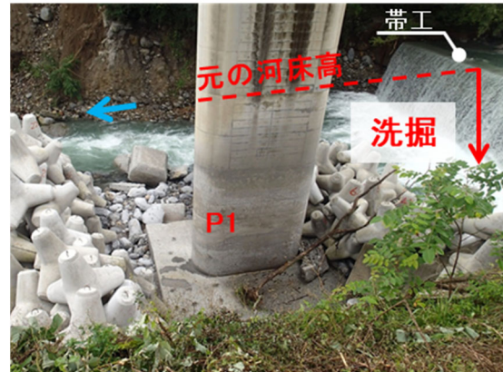
写真-3 基礎地盤周辺の洗掘
