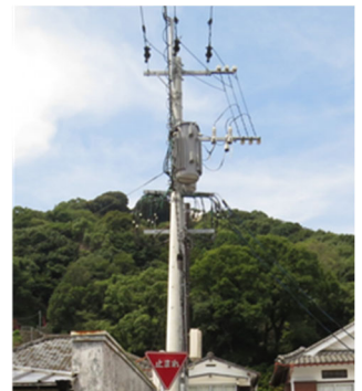
図-5 柱上設置型 (撮影：みち研)
