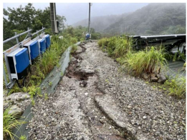
写真-3 (事例2) 管理用通路部の雨水による洗堀状況 (2021年7月, 静岡県熱海市, 静岡県より提供)
