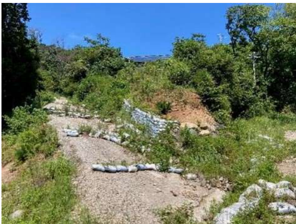
写真-2 (事例2) 開発区域下端部の法面崩落状況 (2021年8月, 静岡県熱海市, 筆者撮影)
