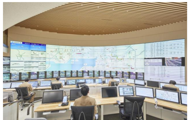
写真-1 交通管制室
