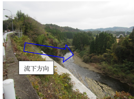
図-8 修正箇所現地写真（藤谷）
