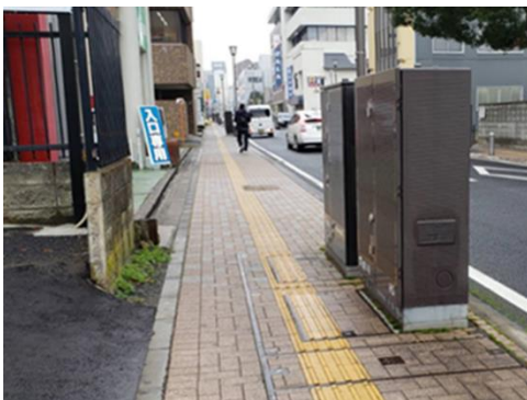
図-3 地上機器の設置例（水戸市）
