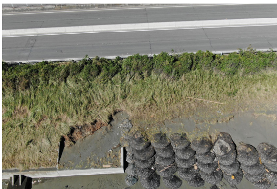
図-21 のり尻浸食箇所
