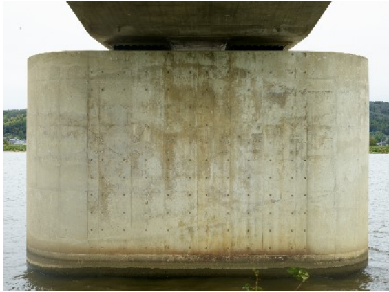
図-3 ひび割れ診断実験対象画像
