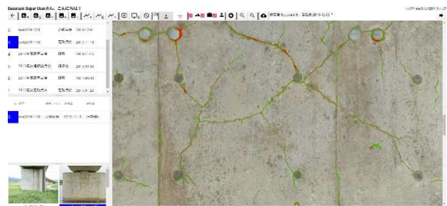
図-2 AIによるひび割れ自動検出の結果の一例
