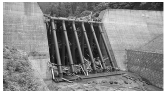
図-1 透過型砂防堰堤（二次製品）による流木等捕捉事例 3)
