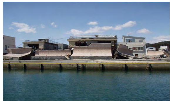
写真-3 転倒した防潮堤 (山田地区)
