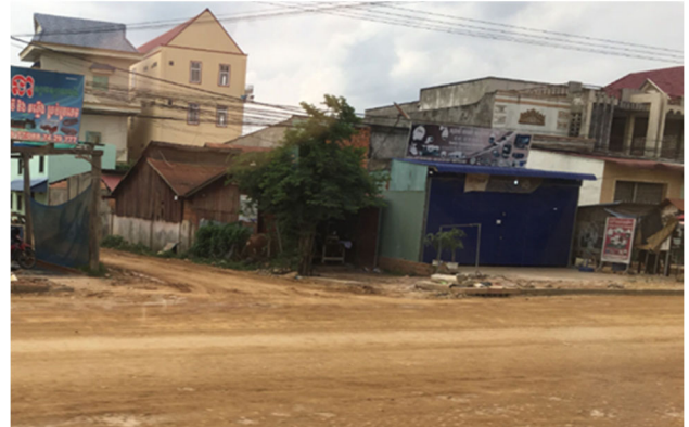
図-18 バベット国境付近の路面状況
