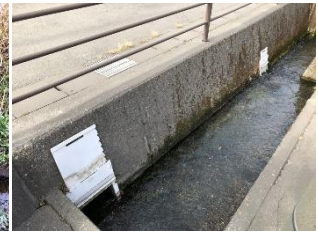
写真-8 可動する弁(池の川)
