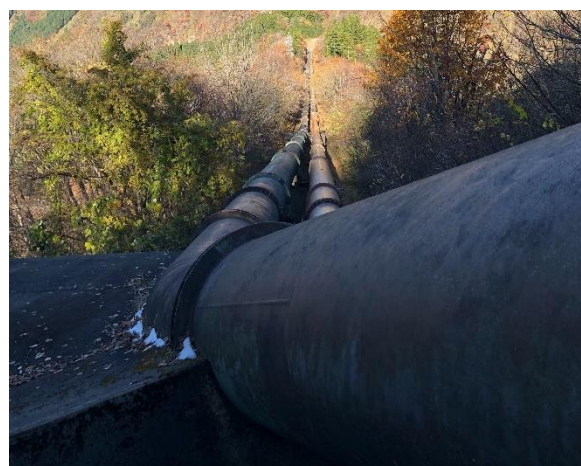
図-1 山間部の水圧鉄管
