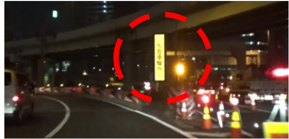
写真-2 LEDサイネージの点灯状況
