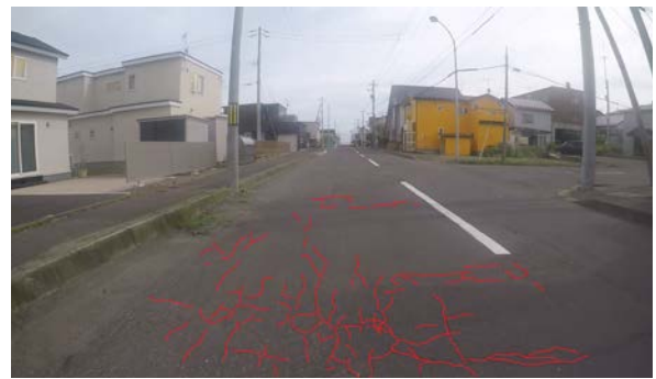
図-4 ひび割れスケッチの例
