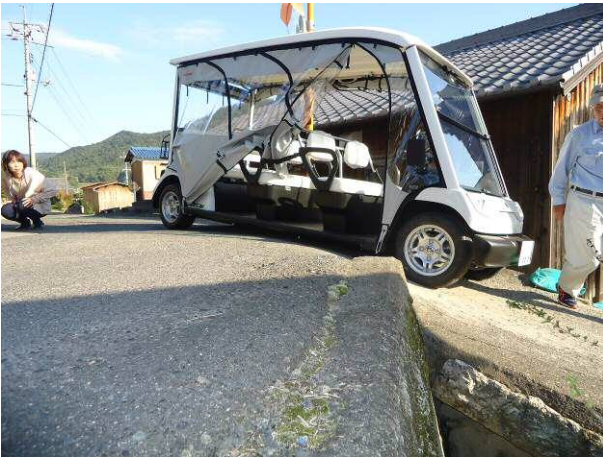
図-6 段差部における通行確認の様子(備前市)
