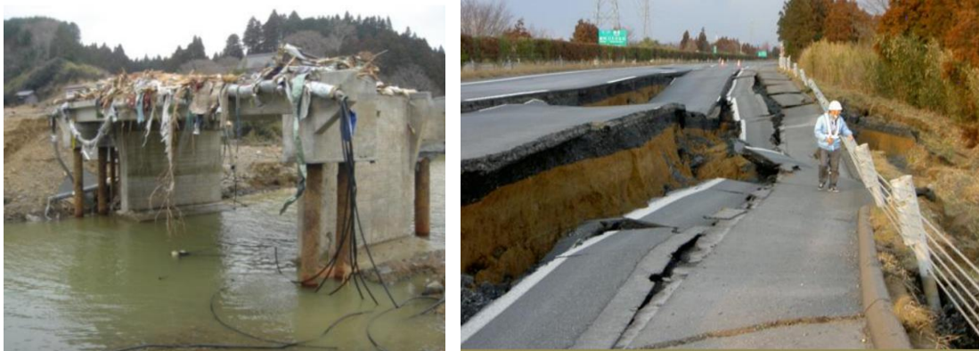
図-2 東北地方太平洋沖地震における道路被害の一例 26)
