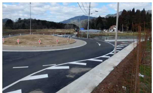
図-23 環道東側の路肩 (A-B 枝間)
