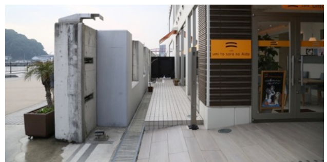
写真-4 防潮壁-建物壁面の空隙
