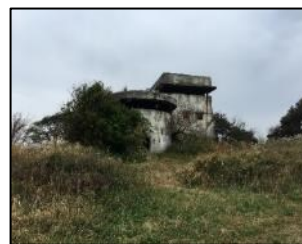
写真-3 荒廃状態の花立台新砲台跡
