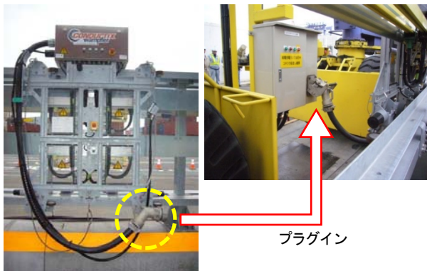
写真-2 給電台車及びRTGの受電状況
