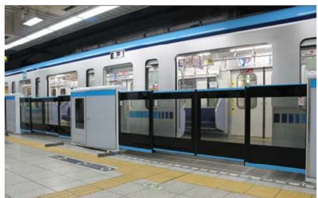
図-8 ワイドドア対応ホームドア設置状況
