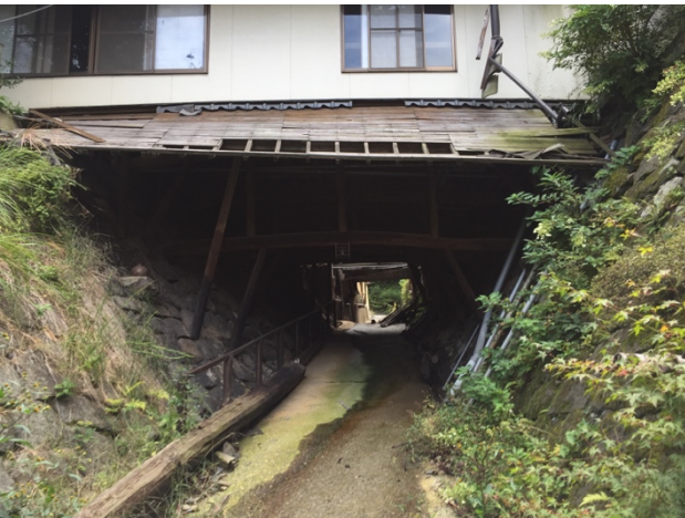
写真-2 被災した石垣
