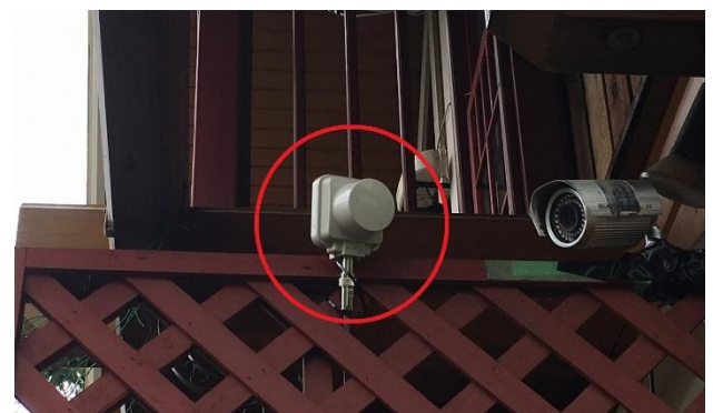
図-3 WCN路側観測器設置状況(上流地点)
