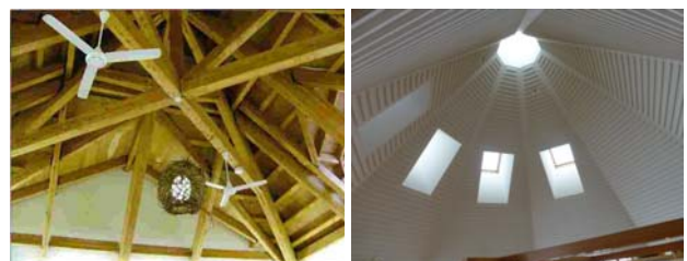
写真-6 左：熱効率が悪い吹き抜け(イメージ) 右：掃除に苦勞する天窓(イメージ)
