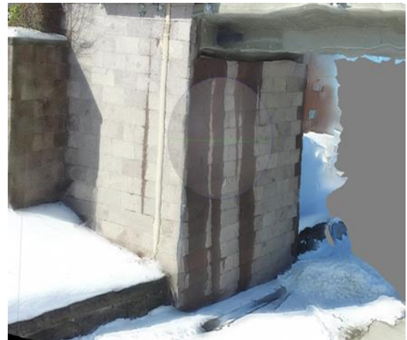
(a) 健全な壁
