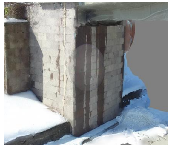
(b) 擬似損傷のある壁
