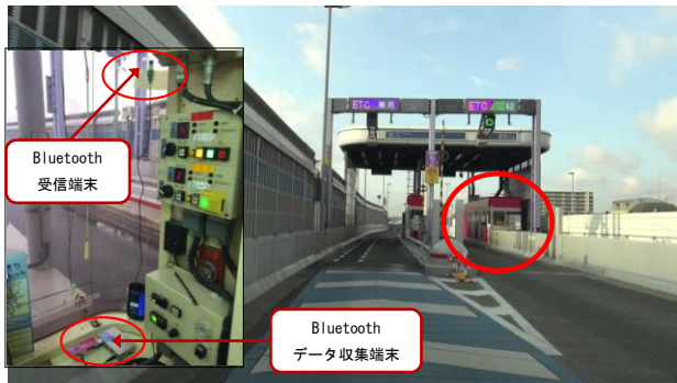
図-2 機器設置状況(深江入口)
