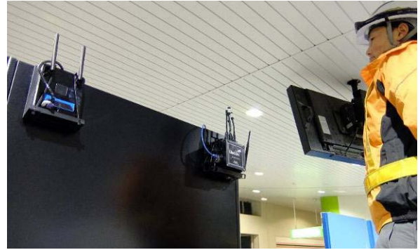
図9 亀岡駅の筐体背面へのセンサー設置
