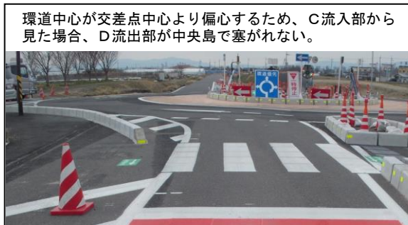
図-11 中央島中心点の偏心の状況(立田町交差点)
