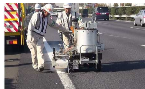
中央破線の施工時 作業員の人身事故が懸念 (上写真は外側線施工状況)
