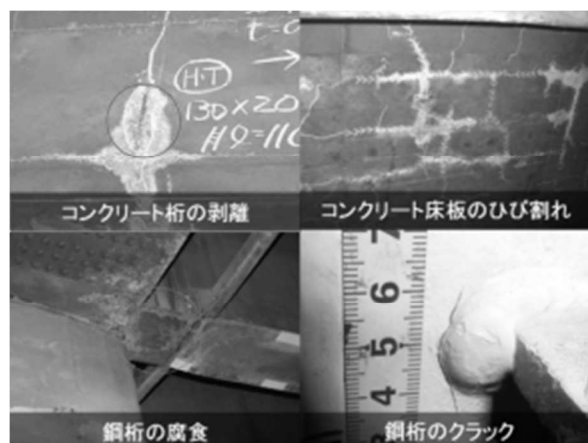
図-3 橋梁上部工の損傷事例 9)
