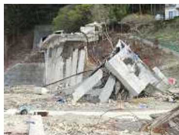
図 1 3 島越駅の橋梁の流出
