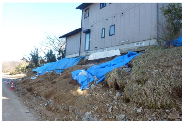
図-2 那須烏山市で盛土部分が崩れた家屋
