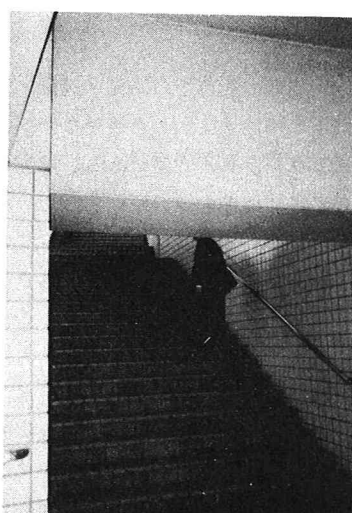
(f) 出口方向の視界がないため、圧迫感のある空間となり、評判が悪い
