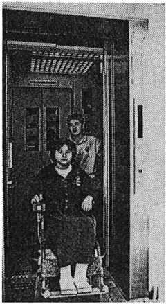
写真1 車椅子に配慮 したエレベータ
