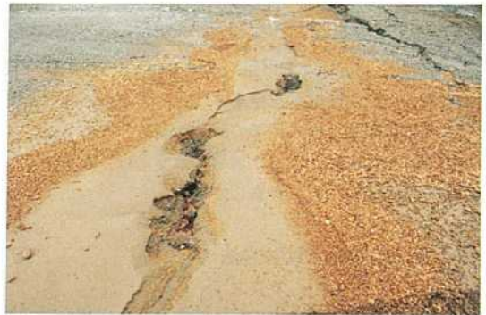
写真-1 北海道東方沖地震による摩周降下生成物の液状化
