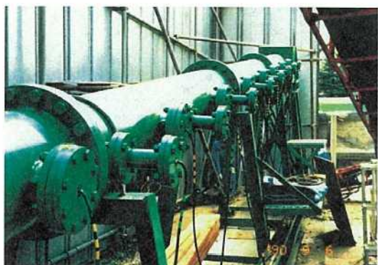
写真-2 スクリューコンベヤセンサ装着状況
