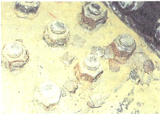
写真-7 高力ボルトの腐食事例(箱桁内部の下フランジ添接部)
