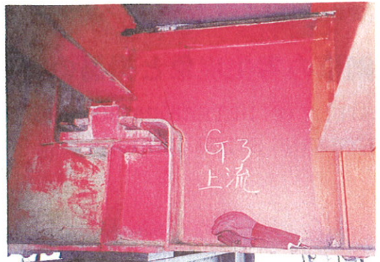
写真-1 アーチ橋側径間との連結切欠き部の疲労損傷事例
