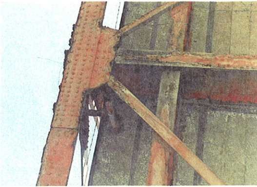
写真-6 下路トラス橋の格点部の腐食事例
