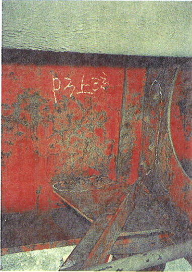
写真-3 塩害による鈹桁橋の腐食事例 (桁内側面の腐食事例)
