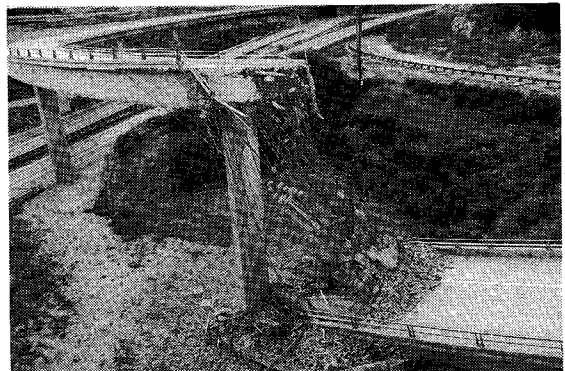
写真-2 I-5/SR-14 インターチェンジの北向線落橋部(村上處直氏撮影)
