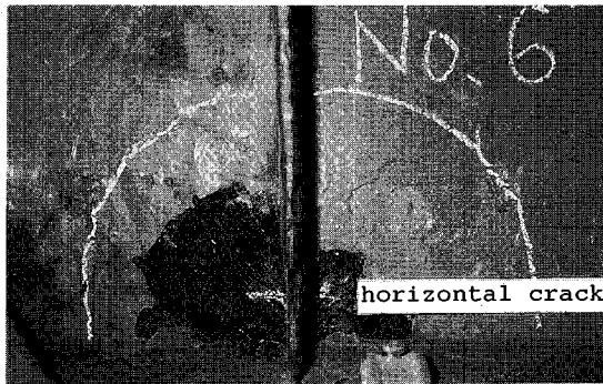
写真-1 横桁ウェブのクラック (補強前)
