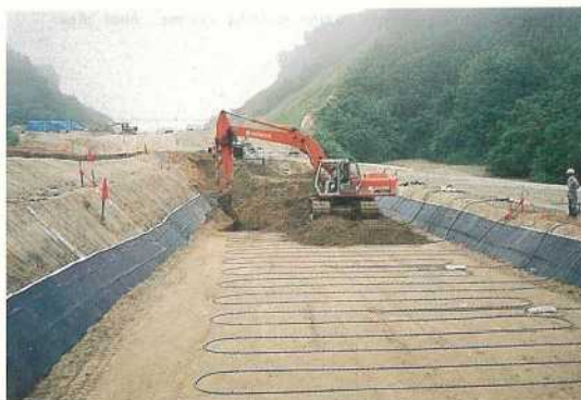
写真-2 盛土内蓄熱部の温水循環パイプ
