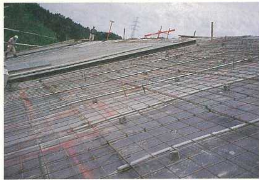
写真-4 のり面ヒートパイプ方式
