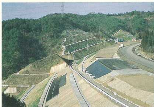
写真-1 盛土内蓄熱・融雪システムの全景
