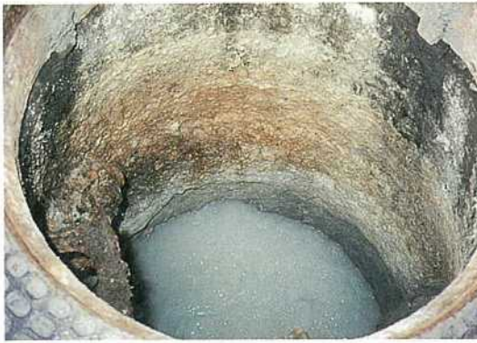
写真一 下水管路から下水処理場へ流れ込む直前のマンホールのコンクリート腐食状況
