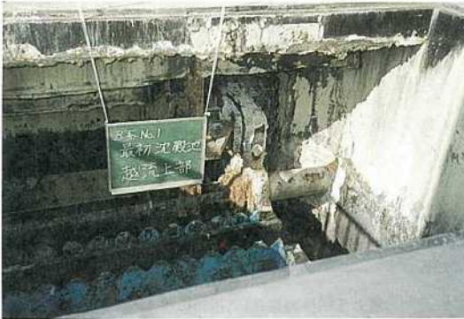
写真二 下水処理場の最初沈殿池のコンクリート腐食状況
