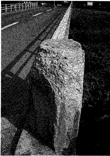
写真一四 親柱の被害
