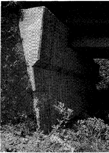
写真-7 橋台の被害
