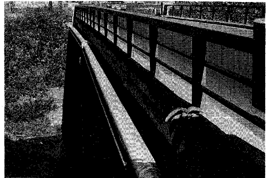
写真-12 管への積雪による橋側面の被害
