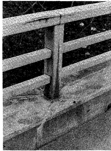
写真-8 高欄ポストの膨張
