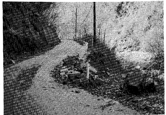
写真-1 剝落型落石の発生例
