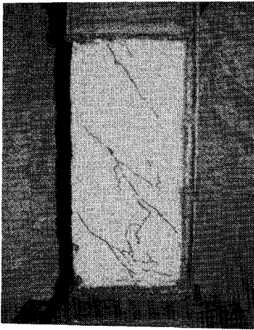
図-9 充填コンクリートの崩壊状況
